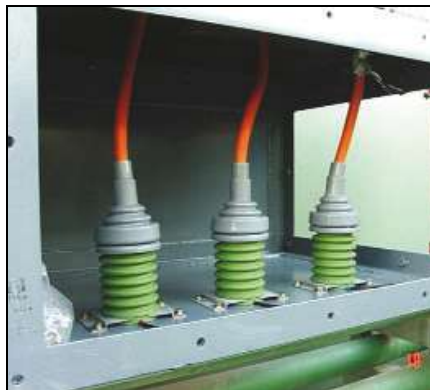
Acoplador Capacitivo Instalado
