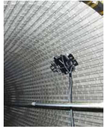
Ensayo robot en progreso en un turbogenerador (la función RIV es opcional)
